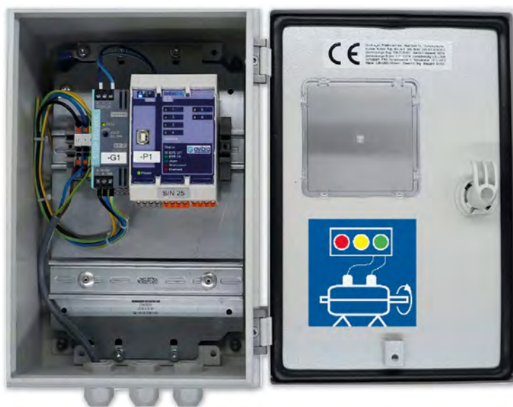
Beispiel einer 4-Kanal-Überwachung montiert in einem Verteilerschrank
